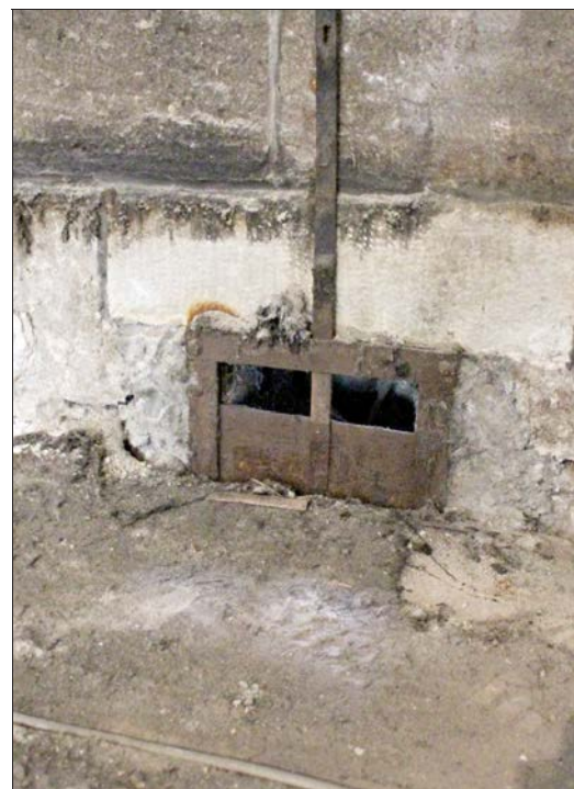
Der Schieber dient der Luftregulung.
